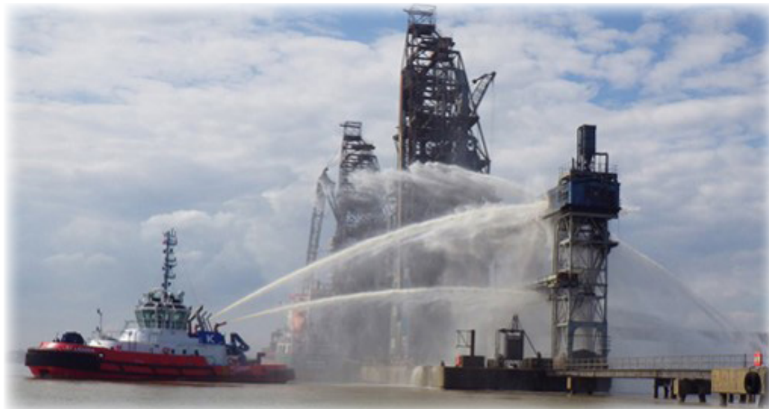
Imagem 1: Fogo no transportador a ser extinguido
