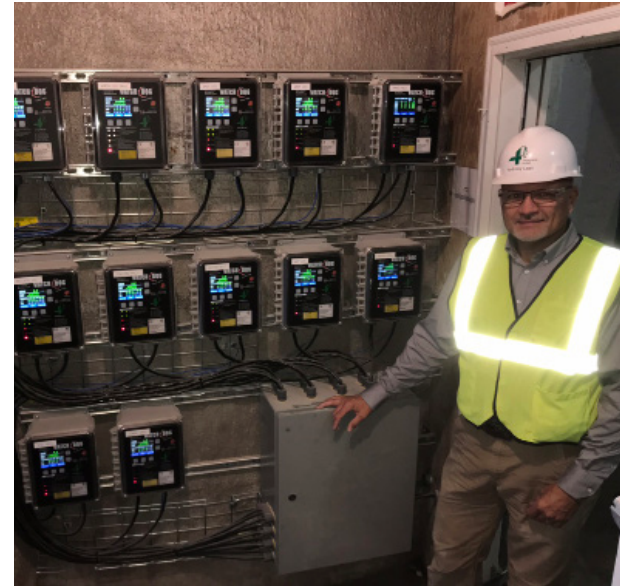
Vários sistemas Watchdog Super Elite e Flex-Net Industrial Ethernet instalados numa sala de controlo da infraestrutura
