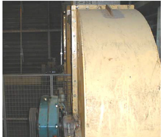
Elevador de alimentação principal
