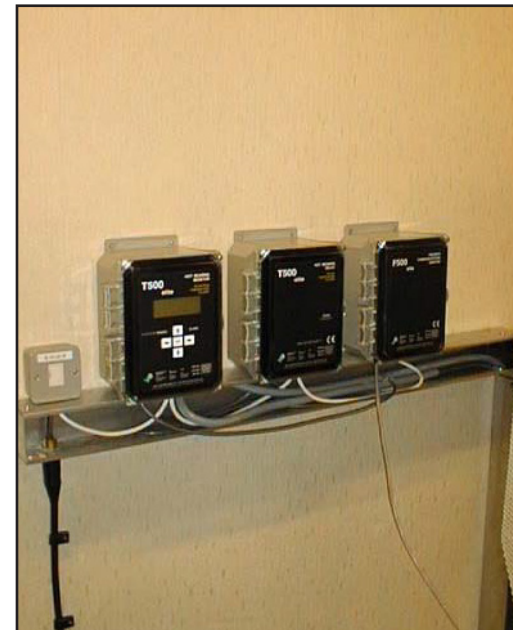
Sistema HotBus™ da 4B instalado numa sala de controlo nas instalações
