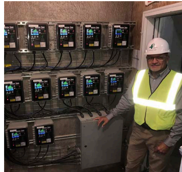
Serie di sistemi Watchdog Super Elite e Flex-Net Industrial Ethernet installati nel locale tecnico di uno stabilimento
