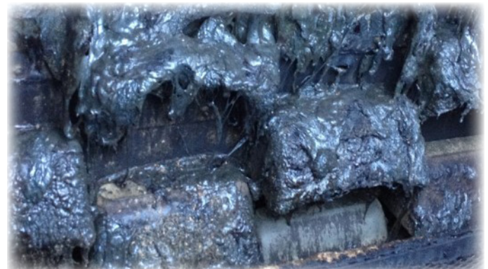
Image 3 : Godets endommagés de l'élévateur adjacent
