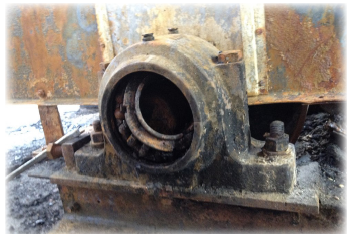
Image 2 : Défaillance du palier ; cause de l'incendie
