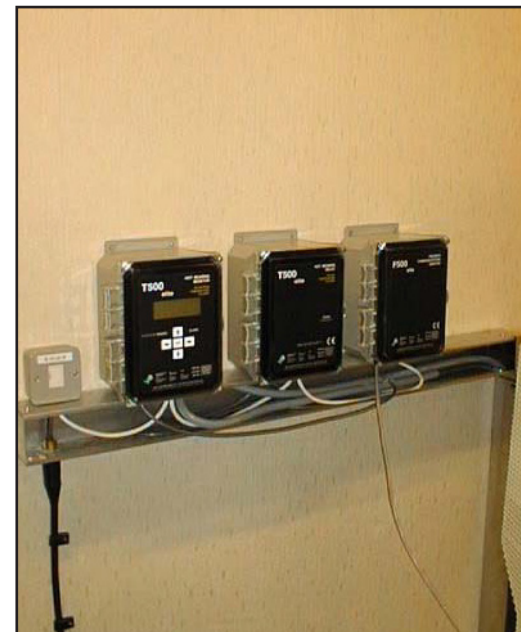
Système 4B HotBus™ installé dans la salle de contrôle
