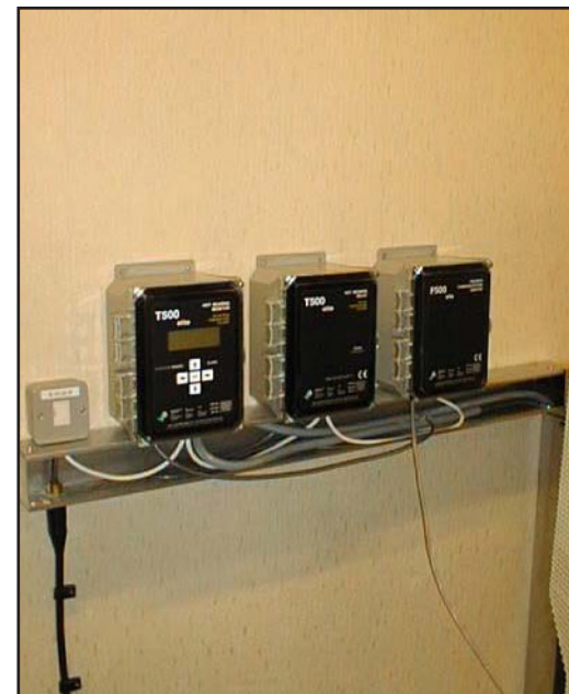
Sistema 4B HotBus™ instalado en la sala de control de la fábrica.
