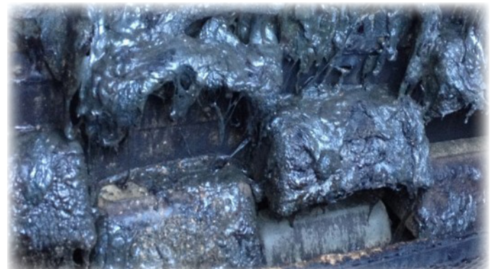
Bild 3: Beschädigte Becher des benachbarten Elevators
