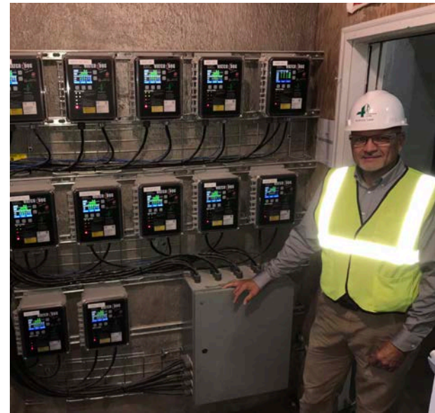
Mehrere Watchdog Super Elite und Flex-Net Industrial-Ethernet-Systeme, im Kontrollraum einer Anlage installiert
