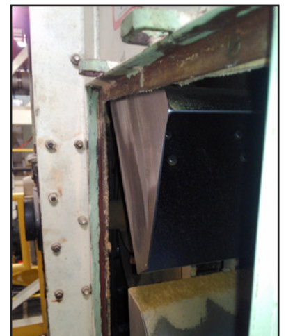
Ein Stahlbecher reibt gegen das Elevatorgehäuse
