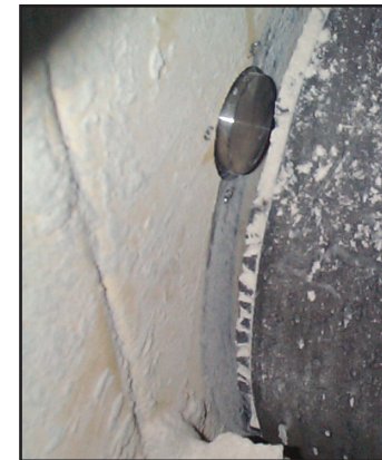
Датчик установлен на стороне мотора закрытого конвейера (вид изнутри)
