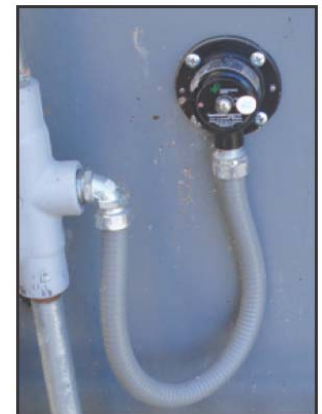
Touchswitch instalado em um elevador de caçamba
