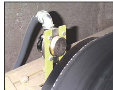
Touchswitch instalado na extremidade de um transportador de correia aberto
