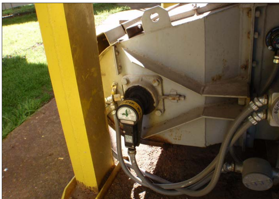
Whirligig® installé sur l'arbre arrière d'un convoyeur fermé avec un M800 Elite Speed Switch
