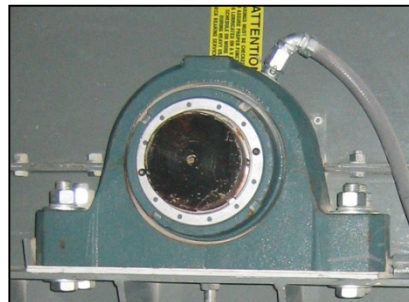
Capteur installé sur le roulement du convoyeur
