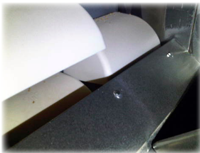
Figura 5: Tazze SPS installate
