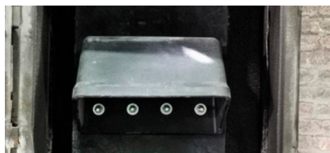
Nylathane™-Becher in einem Glasbruch-Elevator installiert.
