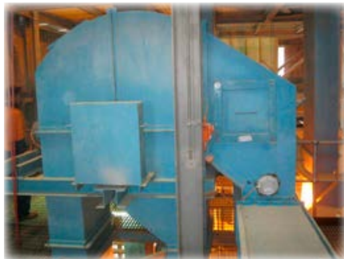
Image 3 : Chute de déchargement – avant modifications
