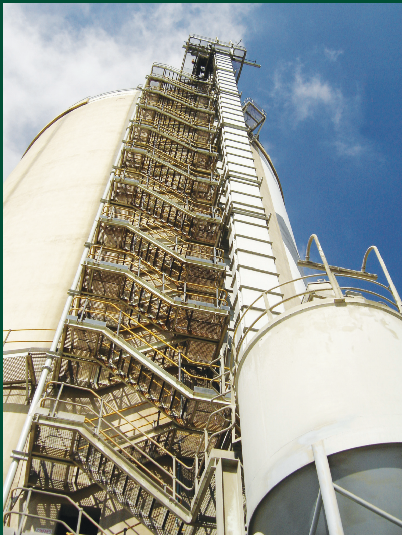
Tall Elevator in Cement Plant 水泥厂的高大型提升机
