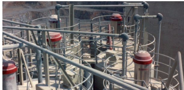
Dépoussiérage de silos avec PNEUFIX et FLOW-BOW®
