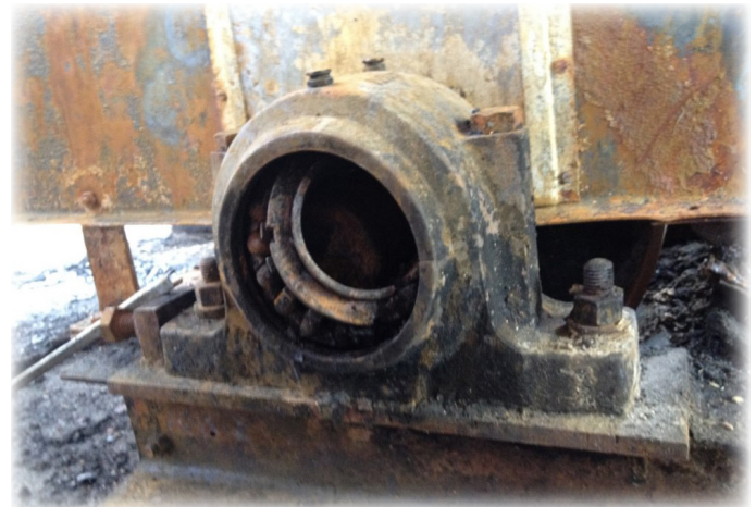
Imagen 2: Cojinete defectuoso, la causa del incendio
